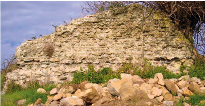
Foto 23. Via dei Monti: la parete meridionale della cisterna (da G. CORDIANO, Sabatia Stagna 2 , Pisa 2011 – dvd –)
